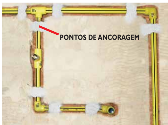
Vista parcial de instalação.
