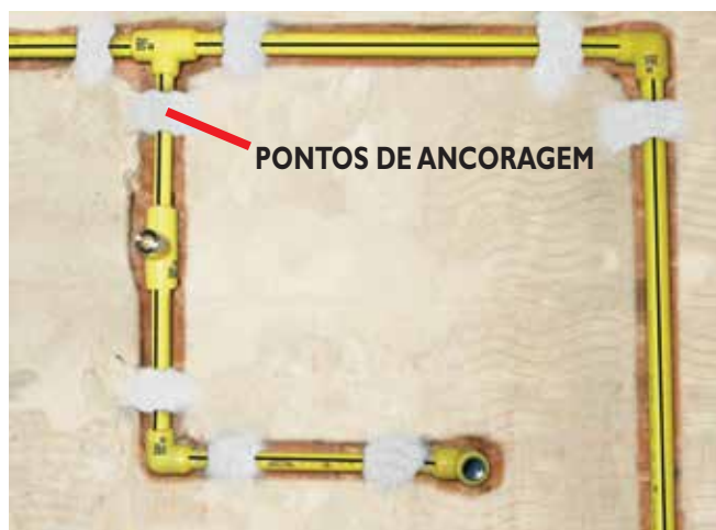
Vista parcial de instalação.
